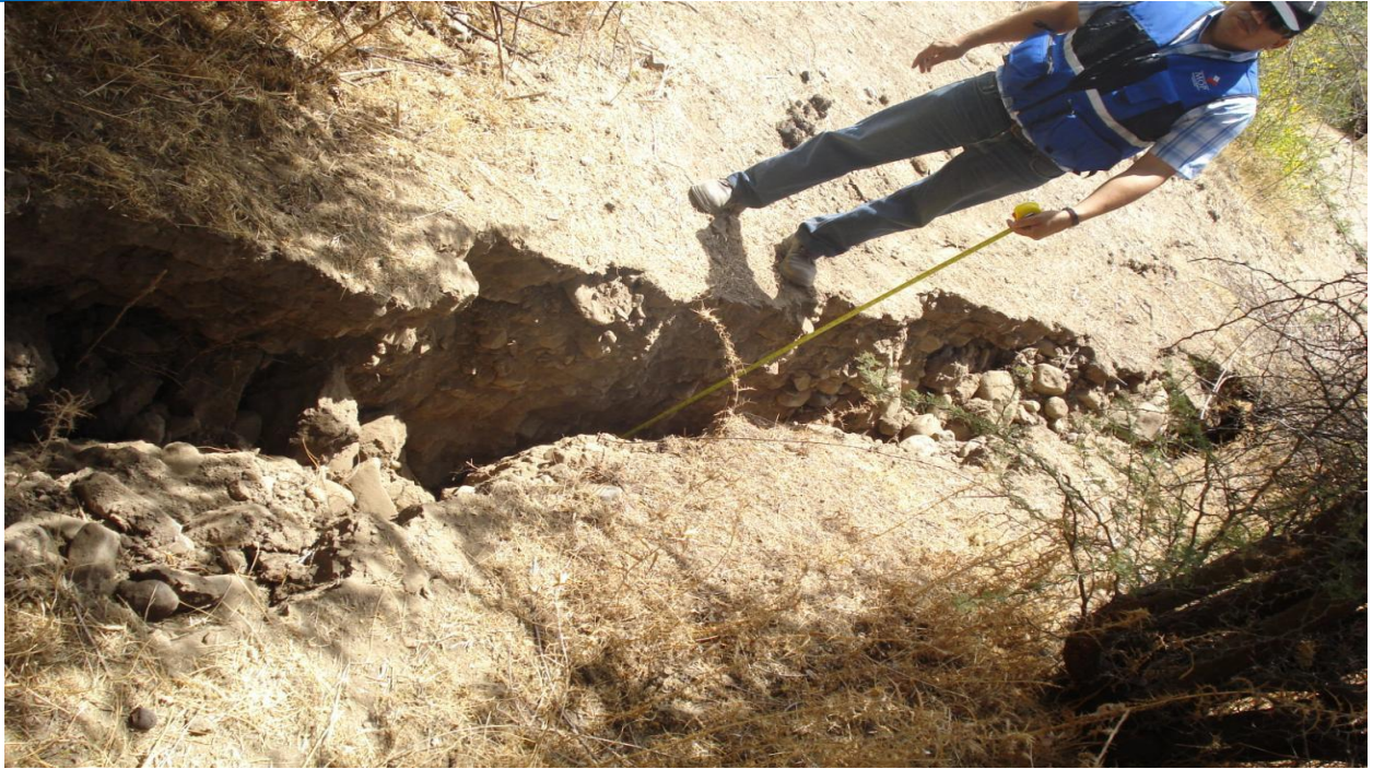
Foto 4. Grieta en coronamiento.
