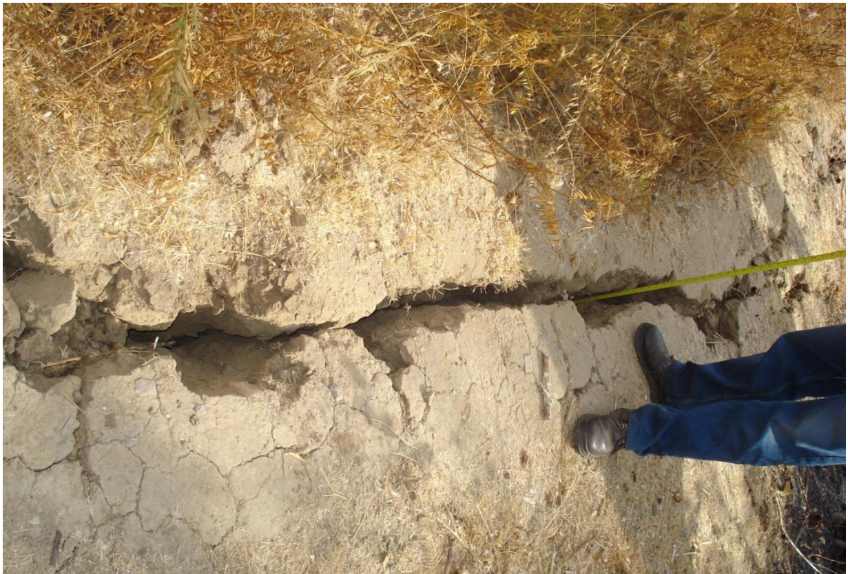
Foto 3. Grieta Longitudinal en coronamiento del Embalse IDAHUE
