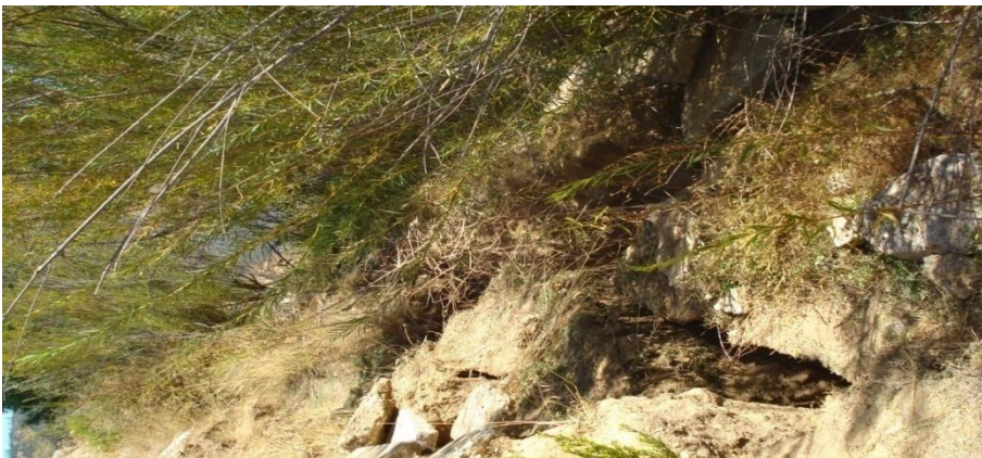
Foto 3. Desplazamiento del Talud interno.
