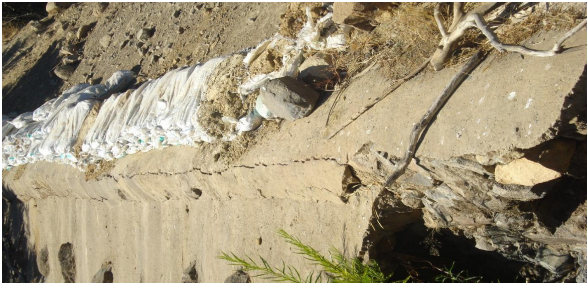
Foto 4. Vertedero de seguridad con Grietas y desprendimiento de material.
