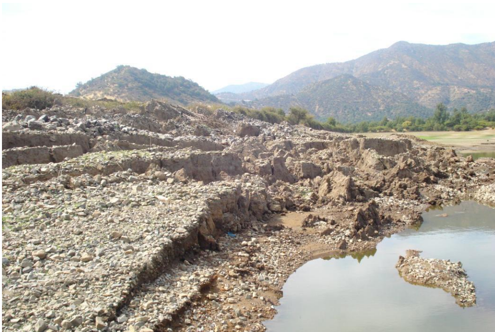
Foto 6. Deslizamiento de material de Coronamiento y del Talud interior.
