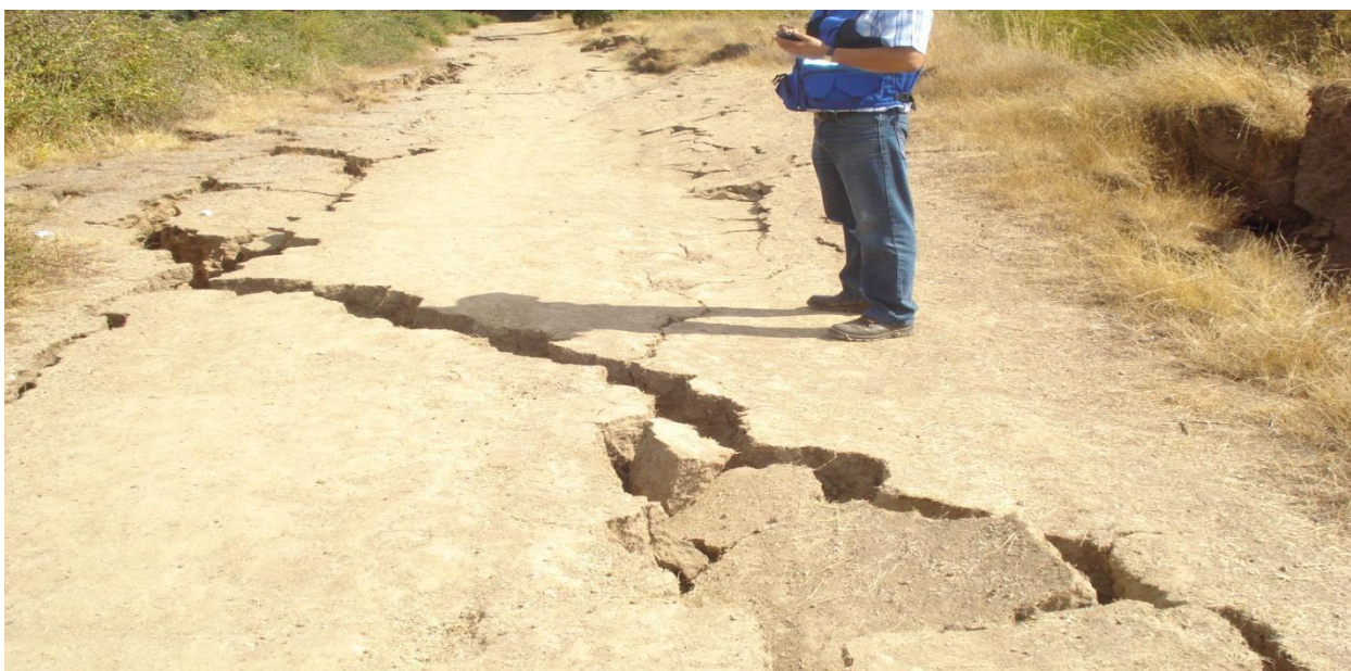
Foto 4. Grieta Longitudinal en coronamiento del Embalse MILLAHUE.
