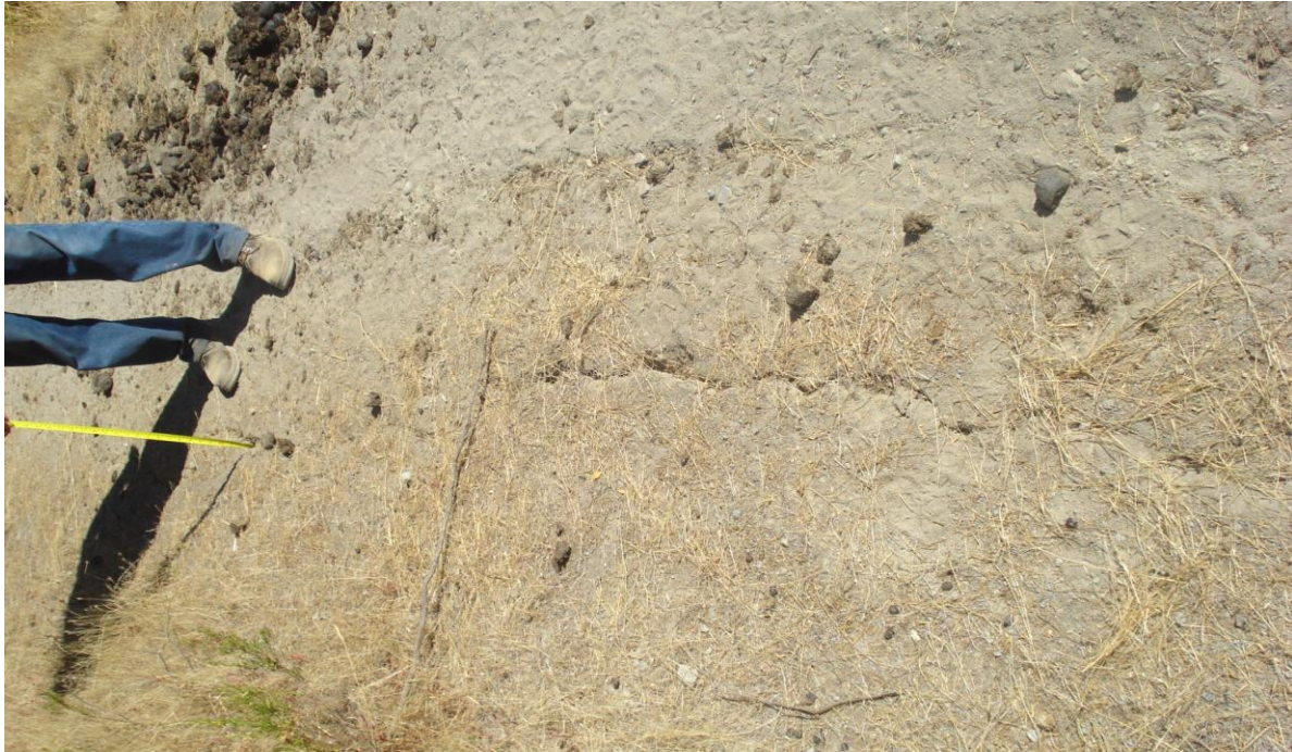
Foto 5. Grieta en el coronamiento del muro.
