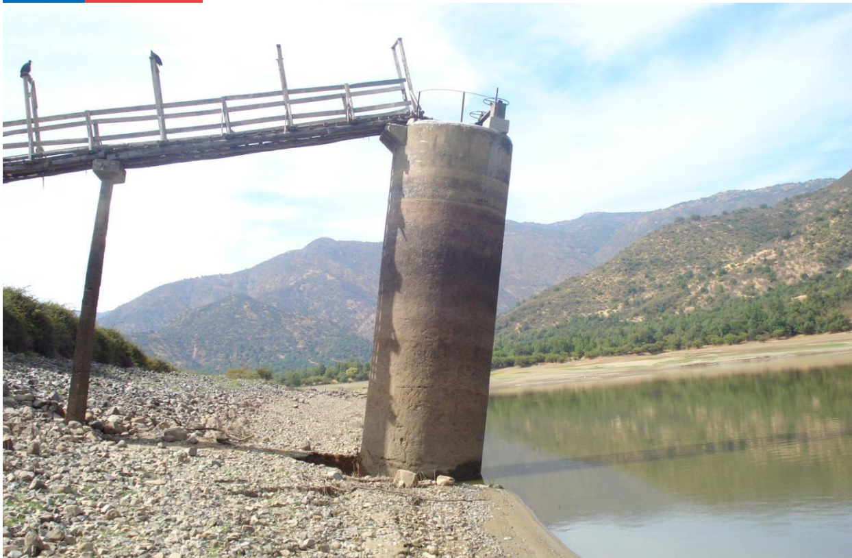
Foto 7. Inclinación de La Torre de Toma hacia el embalse.
