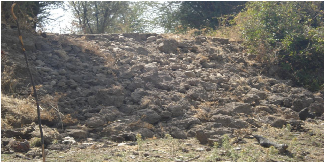
Foto 2. Desplazamiento de material en talud interior.
