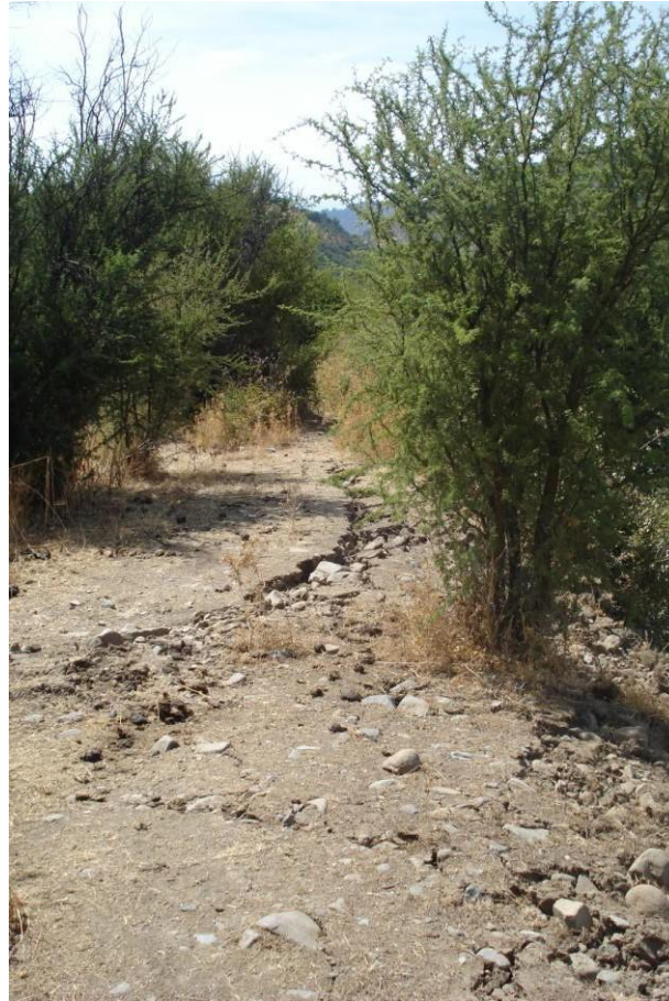
Foto 3. Grieta en el coronamiento.
