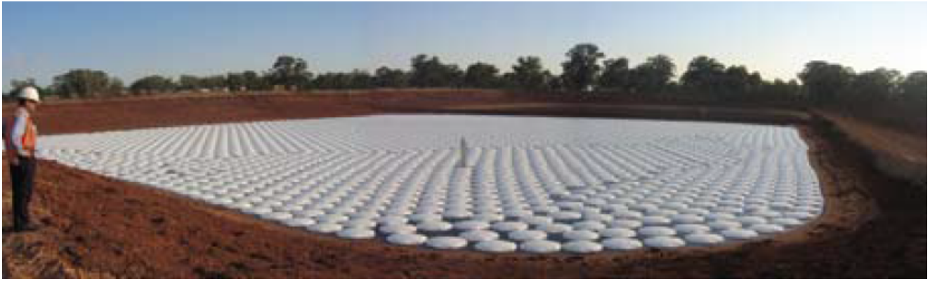
Figure 4-16: Módulos flotantes en un reservorio para almacenamiento de agua a fin de reducir la evaporación para una mina de cobre australiana (de la Australian Leading Practice Guide for Water Management, prueba en la mina North Parkes, NSW, Australia)
