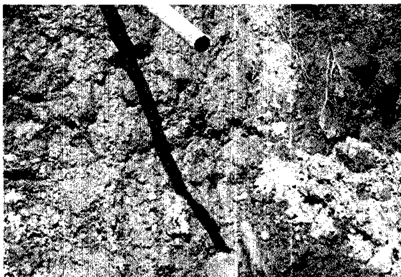
Fotografía 4.7 Vista tubo PVC descarga seca Vertiente Fundo Viña del Cerro.
