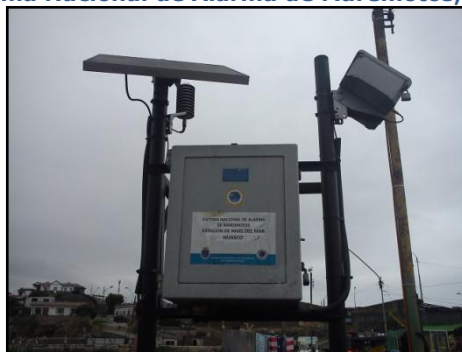
Figura N°4. Sistema Nacional de Alarma de Maremotos, Puerto de Huasco
